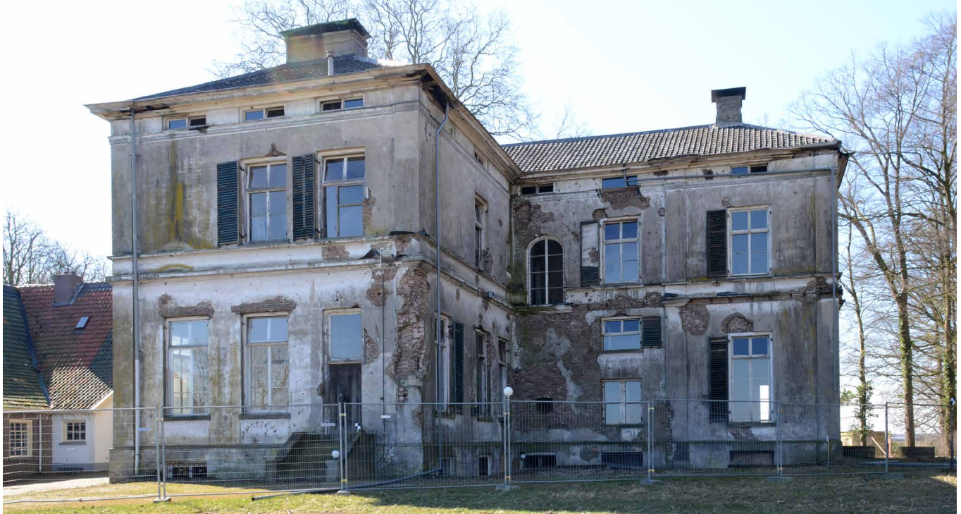
AFB. 7.8 Achtergevel Reuversweerd 'voor' de restauratie (Wido Quist).
